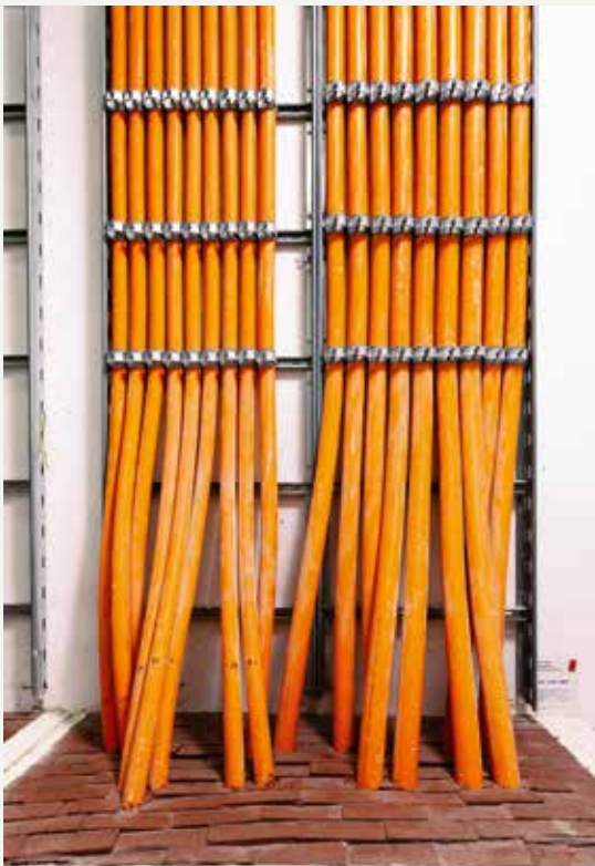
FIG. E Das ziegelartige Bett der Sicherheitsstromkabel bläht sich im Brandfall auf und dämmt das Feuer.
