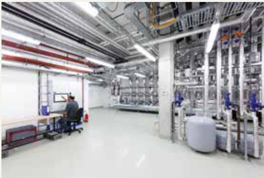
FIG. C In dieser Anlage entsteht Kälte für die Kühlung der Medizintechnik, der Intensivstation und der EDV.
