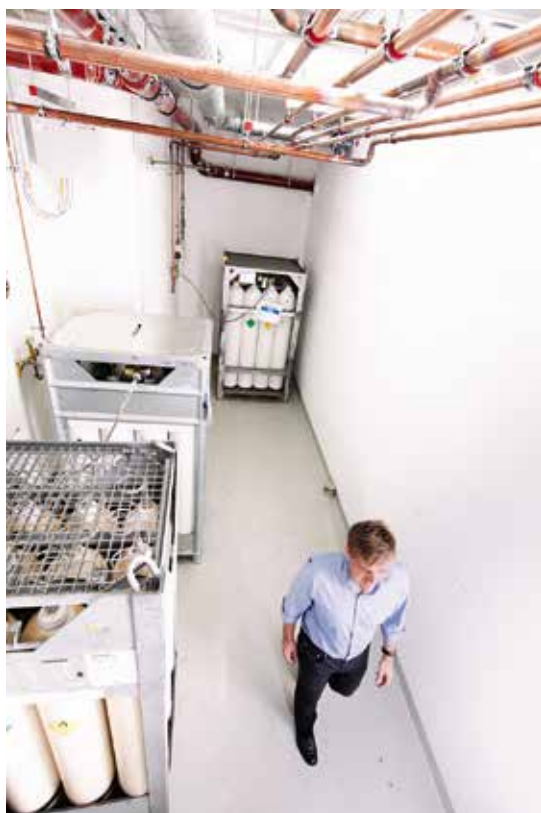
FIG. H Von der Sauerstoffzentrale aus wird das Beatmungsgas direkt ans Krankenbett geleitet.
